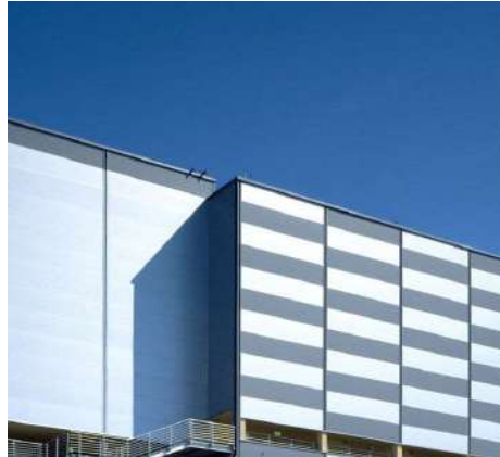
Rajah 7.0 – Penggunaan cladding jenis sandwich panel yang banyak dipasang di pusat data.
